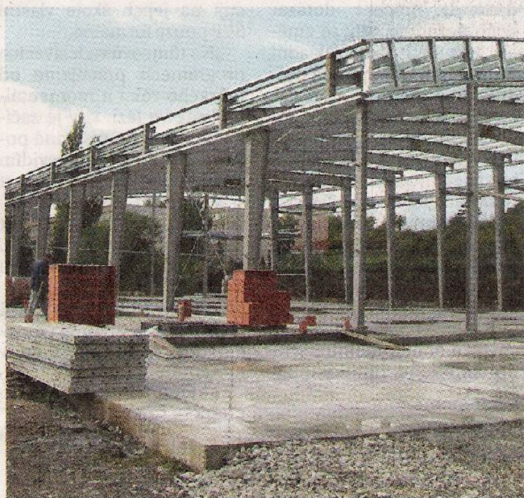
Výstavba víceúčelové haly v Králově Dvoře by měla být dokončena v příštím roce.
